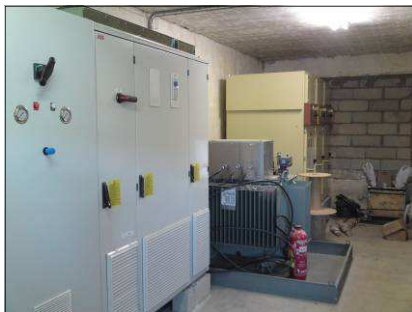
Equipos eléctricos y local técnico de la central
