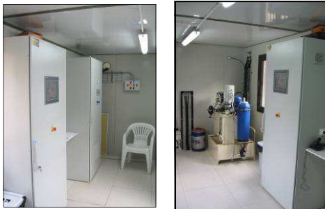
Interior del local técnico
