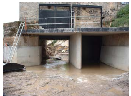
Prise d'eau presque terminée, vannes en place et clapet en attente d'être posé
