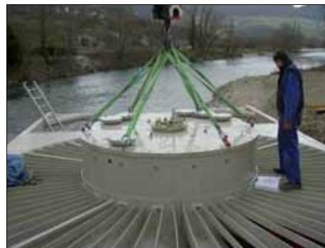
Assemblage du générateur dans le distributeur au dessus de l'arbre turbine
