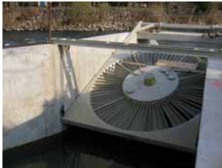
La VLH en position relevée pour maintenance
