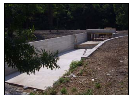
Prise d'eau en dérivation du Canal de restitution de la centrale amont de Vila d'Alme
