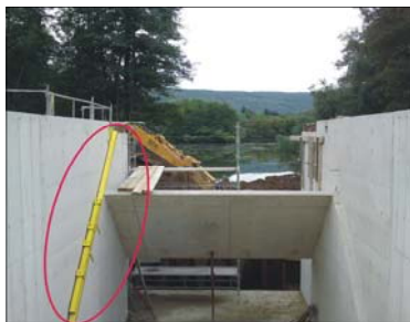
Placement des pièces à sceller avec les outils de positionnement fournis par MJ2
