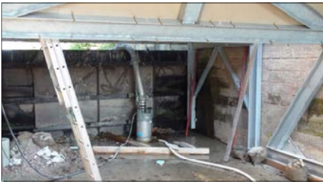
Structure métallique de support de la VLH et du local technique
