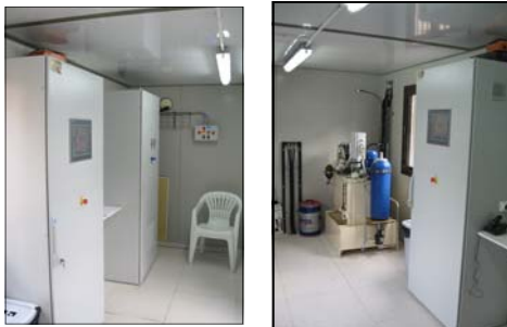
Intérieur du local technique
