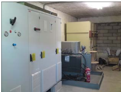
Équipements électriques et local technique
